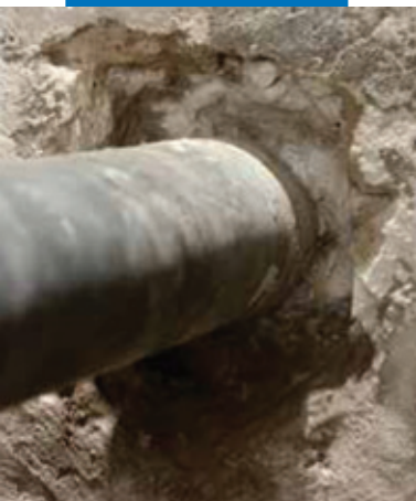
Разрушение конструкции вокруг трубы
